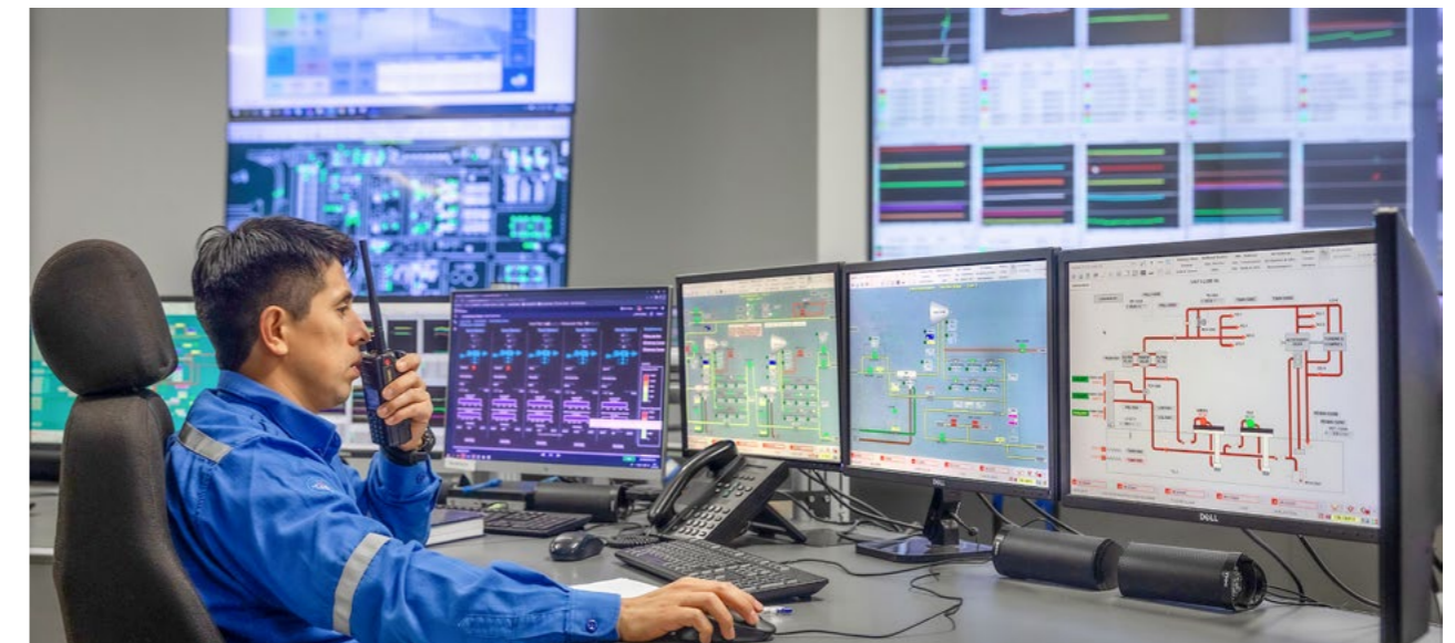
Sala de Control, Planta Malvinas, Camisea. Perú
