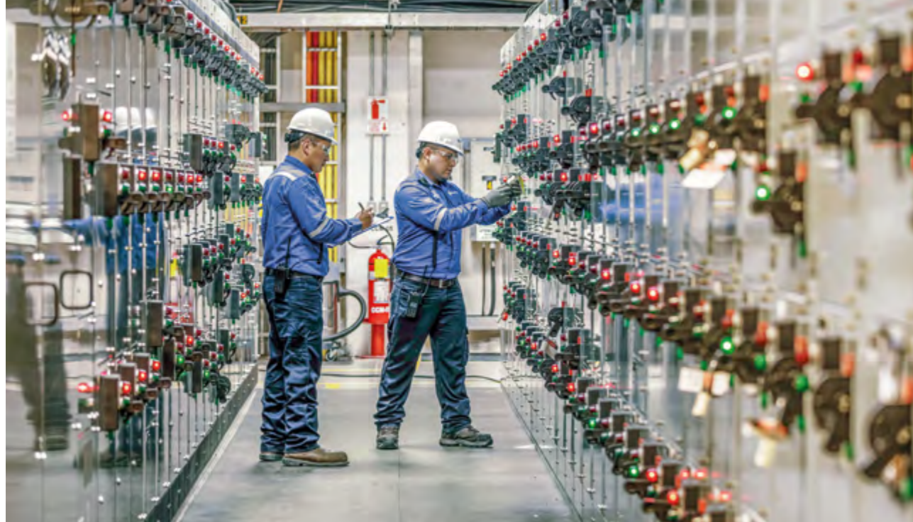
Malvinas Plant, Camisea. Peru
