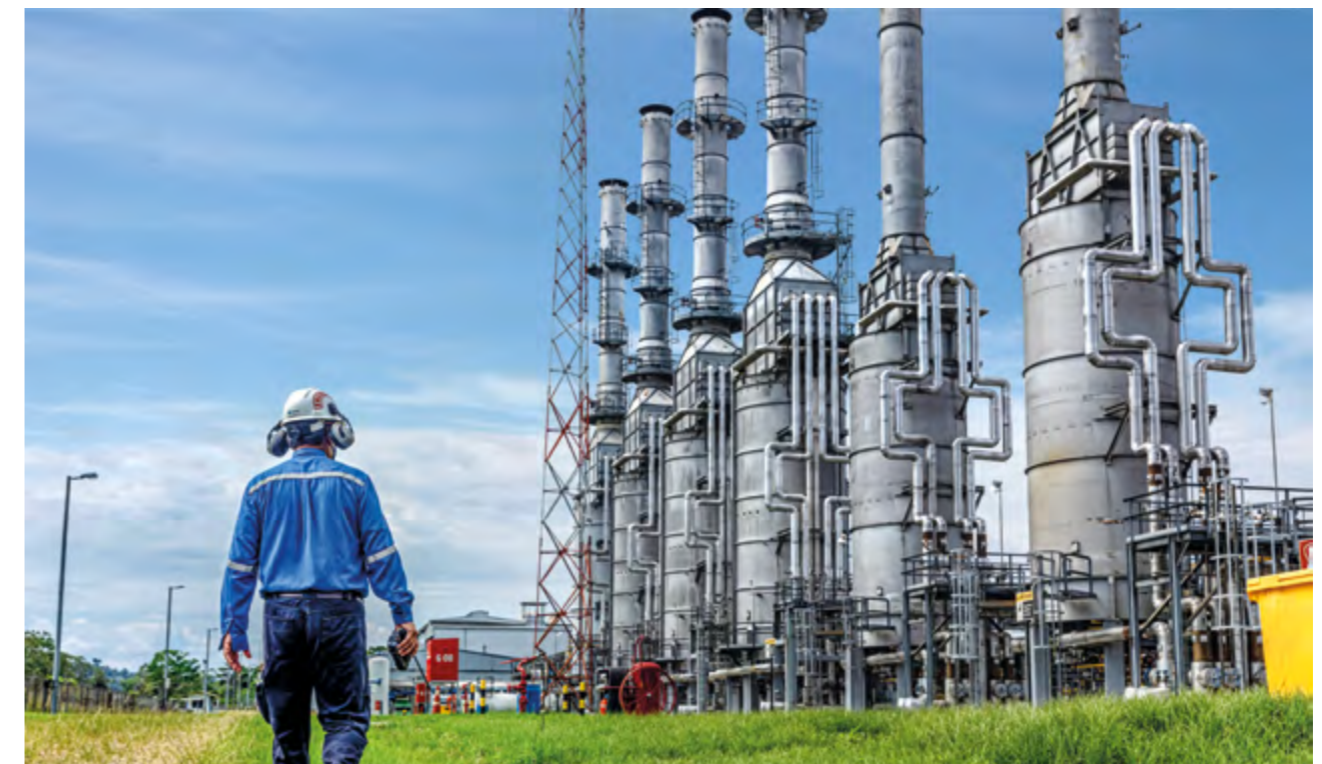
Malvinas Plant, Camisea. Peru
